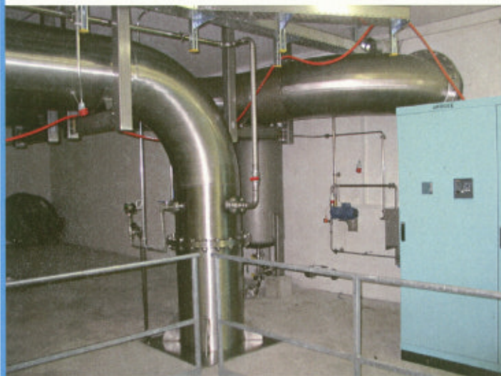
système d'amorçage avec pompe pour extraire l'air de l'eau (station de pompage du Parc Barton)
